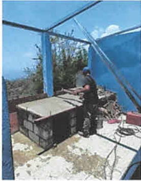
Foto 8: SUSTICION DE CUBIERTA TRADICIONAL CON MADERA POR LAMINA TROQUELADA CALIBRE 26.
